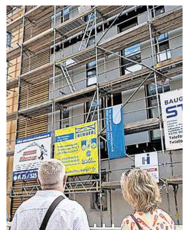
Auch der Neubau Obersteinweg 20a in der Nikolaivorstadt stand im Zentrum des Tages der offenen Sanierungstür in Görlitz 2023.
